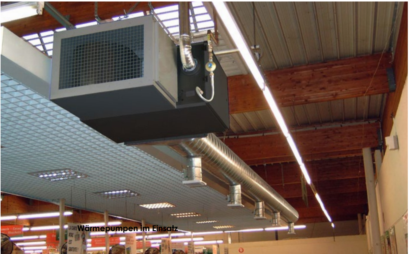
Warmlüfterzeuger im Einsatz
