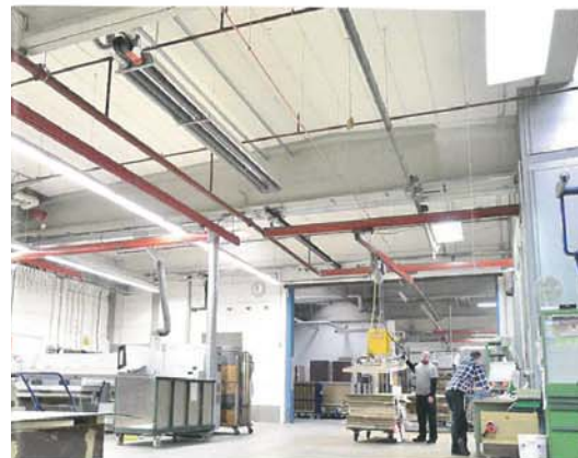
Alte Bausubstanz – neuer Heizkomfort: Das angenehme Raumklima ohne Zugluft und Staubaufwirbelungen hat auch die Biffar-Mitarbeiter überzeugt.
