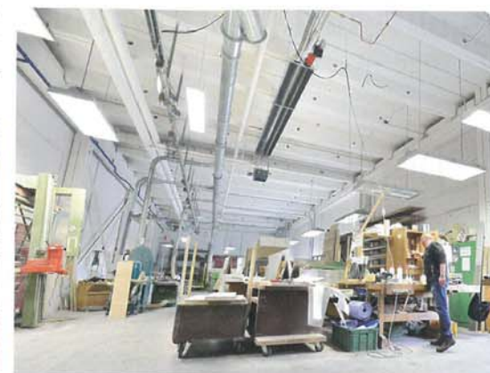
In der Schreinerei, wo viel Luft abgesaugt wird, spürt man die Vorteile der Infrarotwärme am deutlichsten.
