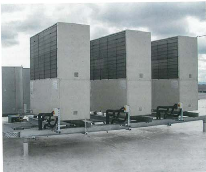
1 Gasmotorwärmepumpen in einer 3-Kaskade.
